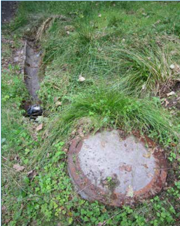
Verrohrte oder mit Halbschale befestigte Gewässer mitten in der Waldlandschaft Pfälzerwald sollten rückgebaut werden
