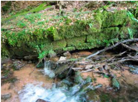
Diese unterspülte Ufermauer ist noch erstaunlich intakt
