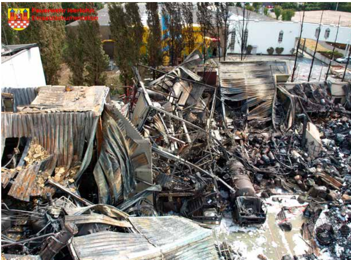
Zerstörtes Chemikalienlager nach einem Großbrand
